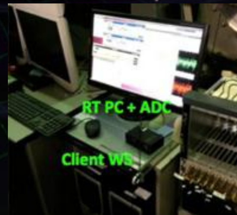
開発中の干渉計診断システム
